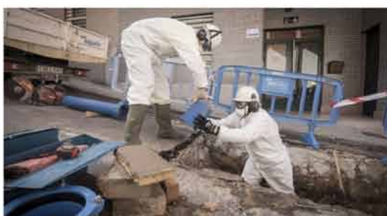
Servicios de Aqualia en la red de abastecimiento de Salamanca.
