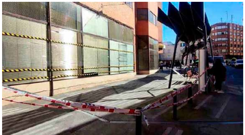
La grieta del edificio de Correos es de pequeñas dimensiones pero recorre toda la fachada de la Corredera. / L.G.C.
